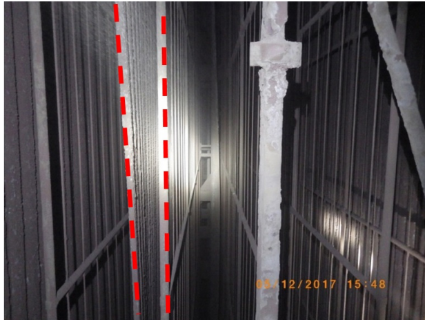
圖 12 Chamber A 第二室集板嚴重變形彎曲
